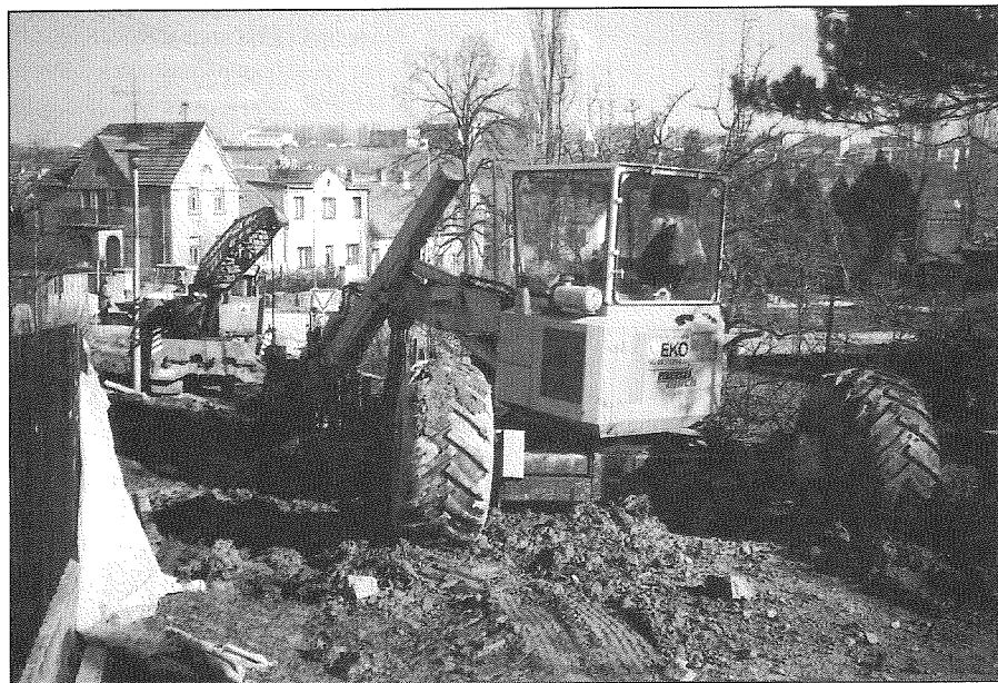
Přestavba kanalizace a vodovodu ve spojení ulic Turistická a Žebětín v březnu 1995
